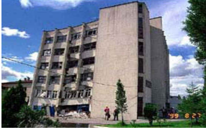
(b) ضرر مبنى ذو جملة ثنائية نتيجة هبوط الأساسات ودوران الجدار
