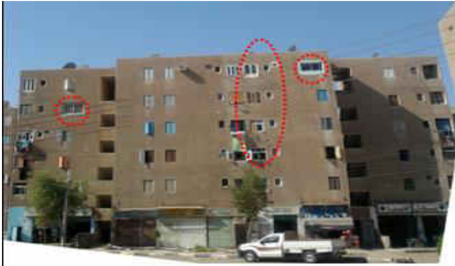
شكل (1- أ): (تفصيل البلكنات - تغيير مقاسات ونماذج الشبائيك) مساكن المحمودية، أسوان، مصر
