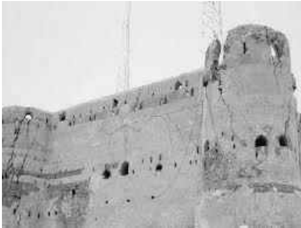
صورة (9-2) : معظم هذه الشروخ ممتدة بكامل ارتفاع هذه الحوائط ونافذة من خلال وجهي الحائط
