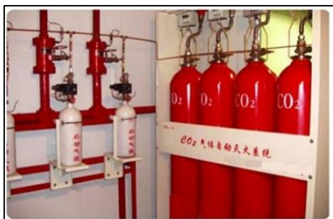
شكل (12): أنظمة الإطفاء الآلي للحريق
