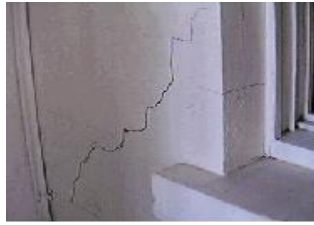
شروخ بالحوائط الخارجية للمبنى نتيجة حدوث هبوط بالأساسات
