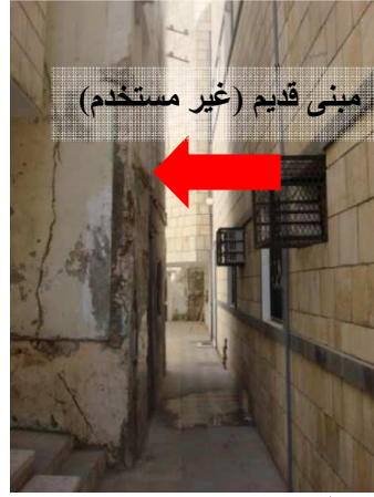
شكل رقم(20):مبنى غير مستخدم بسبب قدم بناؤه
